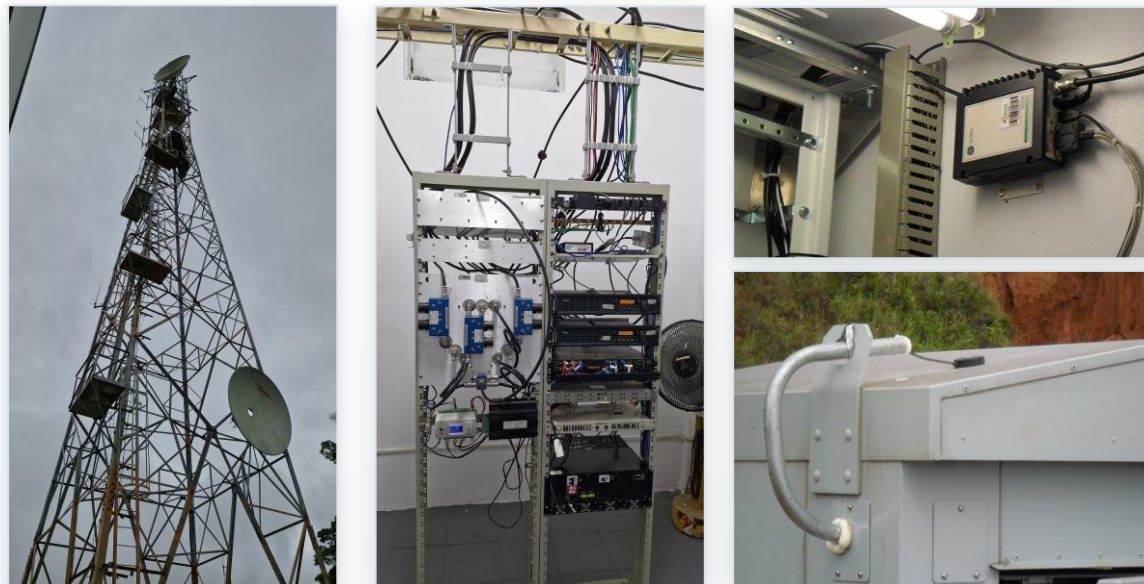
Figura 1 – Rádios de Dados em campo: torre de antenas, bastidor de equipamentos, transceptor em armário e antena de GPS. Fonte: acervo técnico da MRS Logística (2026).
