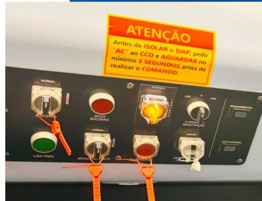
Figura 07: Comutador de derivação instalado no console.
