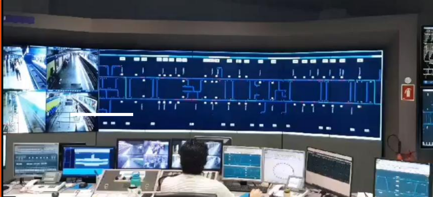
Figura 1 – Ambiente do CCO e painel de monitoramento de trens. Fonte: Metrô de São Paulo / acervo do projeto.
