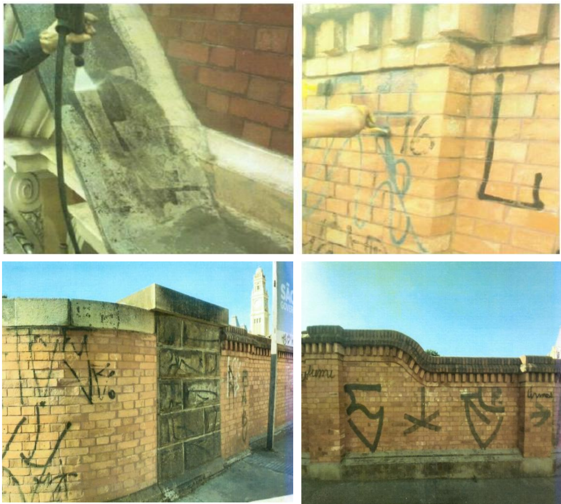
Mosaico fotográfico de patologias, crostas negras, pichações e perda de seção em tijolos. Fonte: Caderno de Manutenção, Sarasá.
