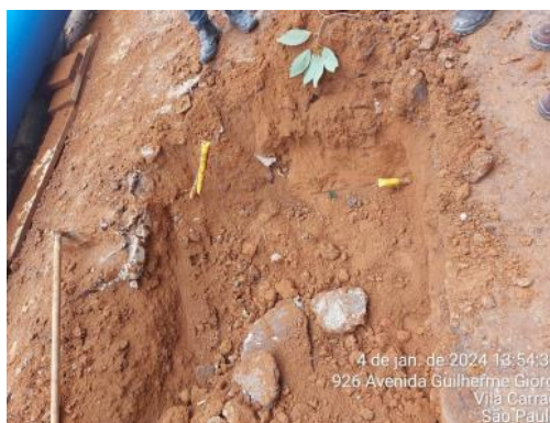
Figura 23 - Rede de gás rompida
