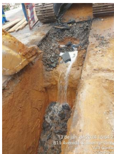
Figura 24 - Rede de água rompida
