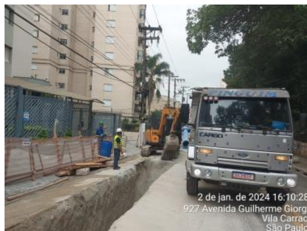
Figura 21 - Escavadeira descarregando material e bloqueando acesso de entrada e saída de veículos
