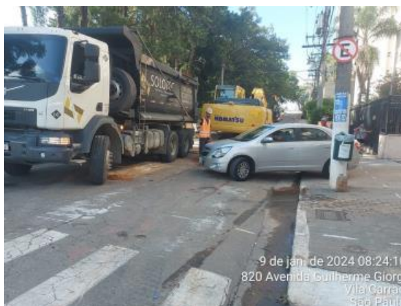
Figura 22 - Dificuldade de saída do morador devido bloqueio irregular
