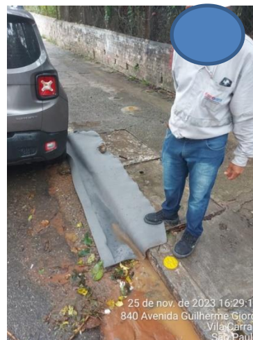
Figura 18 - Bocas de lobo protegidas com geotêxtil para evitar contaminação da rede de água pluviais
