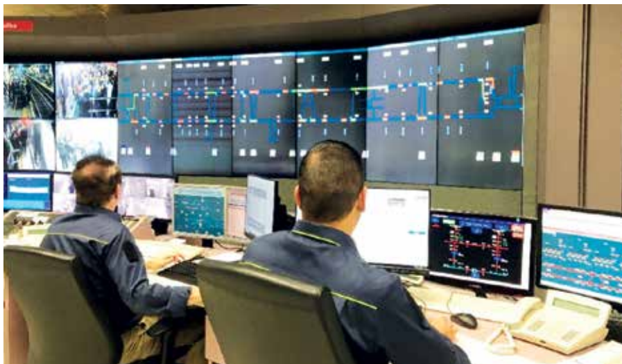
Figura 4 - Sala de controle atual - CCO do Metrô-SP
