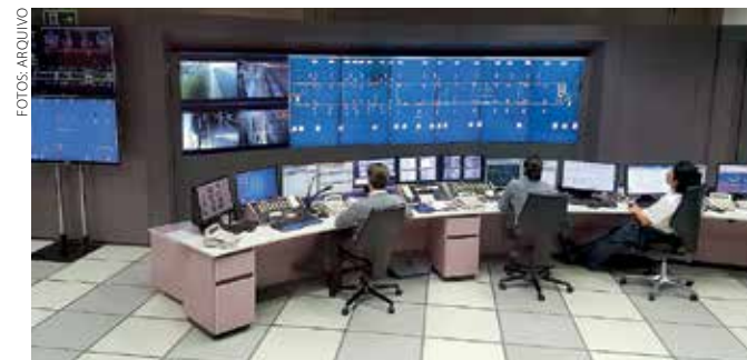
Centro de Controle Operacional
