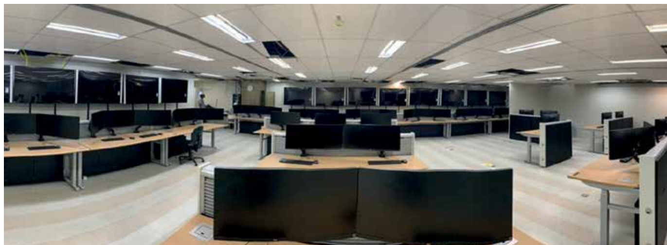
Figura 5 - Instalações provisórias do CCO no 2º andar
