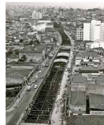
Figura 1 - Vala a céu aberto na zona sul da cidade - Linha 1-Azul, anos 1970 (Metrô-SP)
