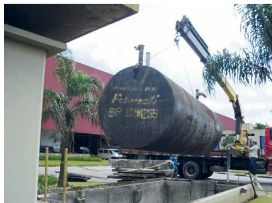
Figura 5 - Remoção de tanque de combustível subterrâneo no Pátio Itaquera da Linha 3-Vermelha (arquivo Metrô)
