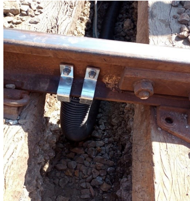
Terminal antifurto e rede subterrânea
