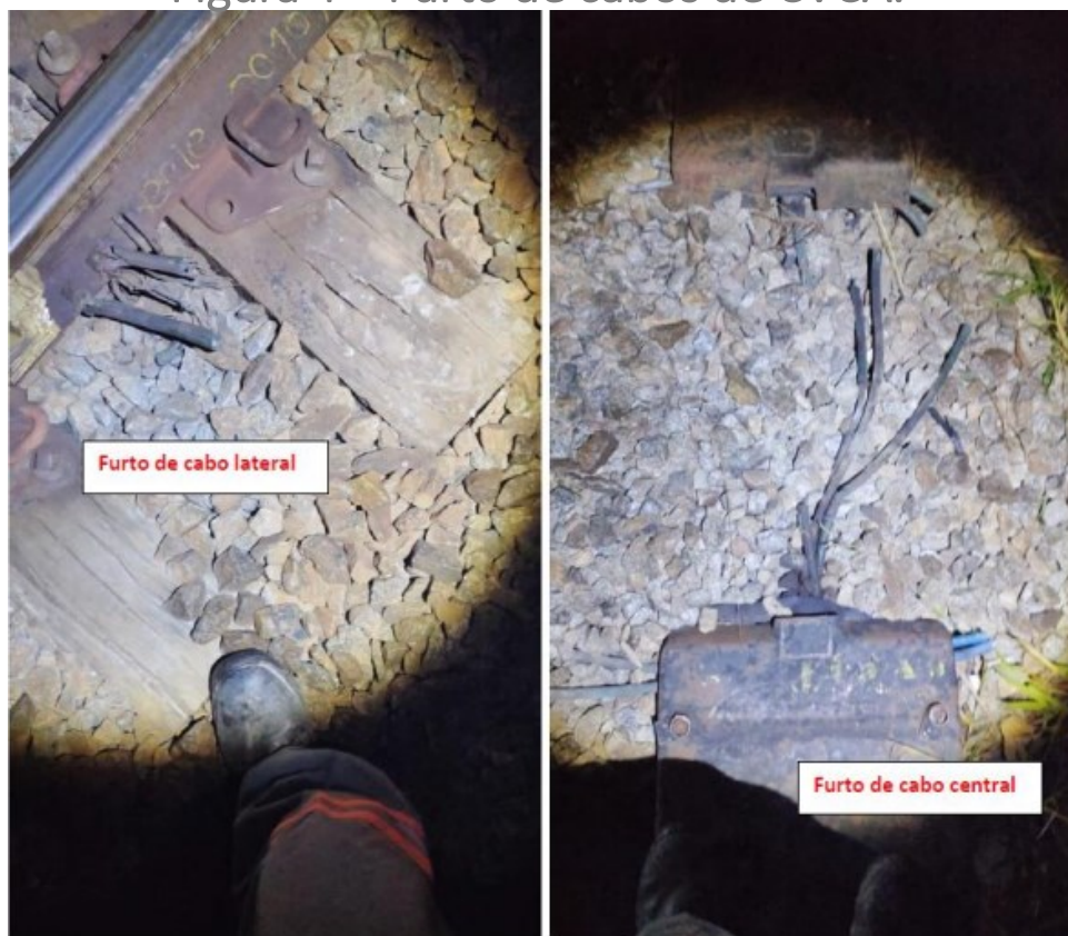
Figura 4 – Furto de cabos de CVCA.
